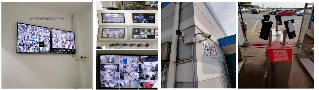
公司监控，门禁管理
